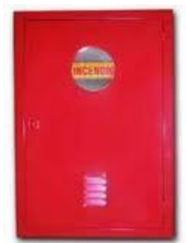
Figura 11. Hidrante de parede
