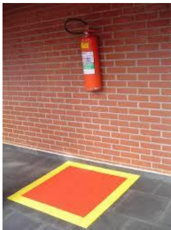
Figura 9. Sinalização de piso – Demarcação do Extintor
