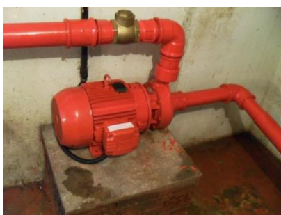
Figura 12. Bomba de incêndio
